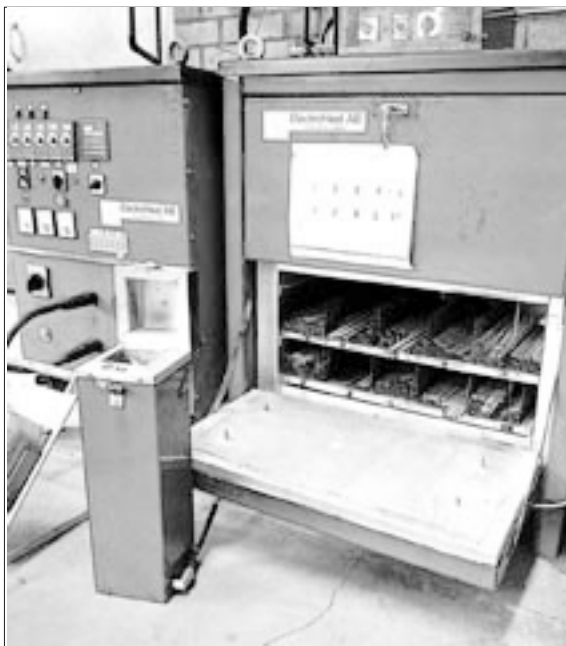
Trockenschrank zur Aufbewahrung der Schweißelektroden.
